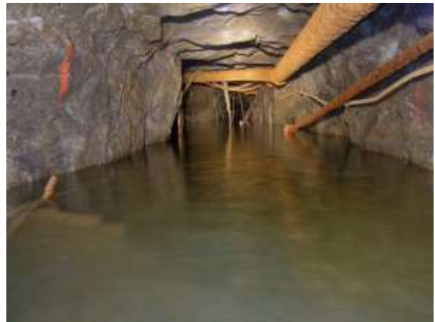
Abbildung 12: Eingestauter Sedimentationsraum südlich des Hochpunktes des Tiefen Büнау Stollns.
